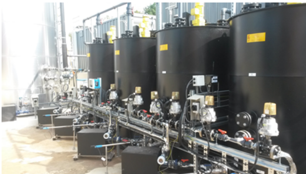
FIGUUR 2 EPHYRA ® PILOTINSTALLATIE TOLLEBEEK (4 REACTOREN IN SERIE)
