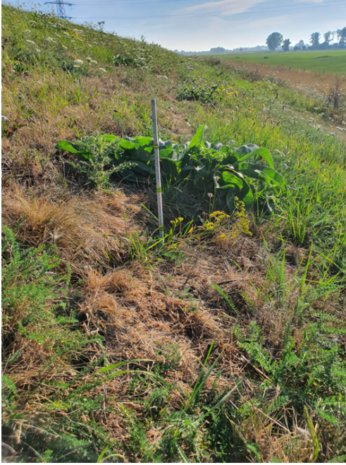
OPPERVLAKKIGE SCHEUREN IN HET TALUD, WATERSCHAP VALLEI EN VELUWE
