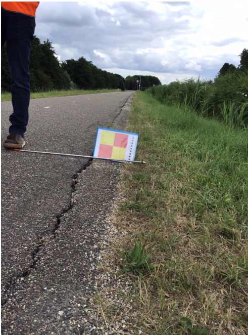
LENGTESCHEUREN IN HET ASFALT BIJ HET HOOGHEEMRAADSCHAP HOLLANDS NOORDERKWARTIER
