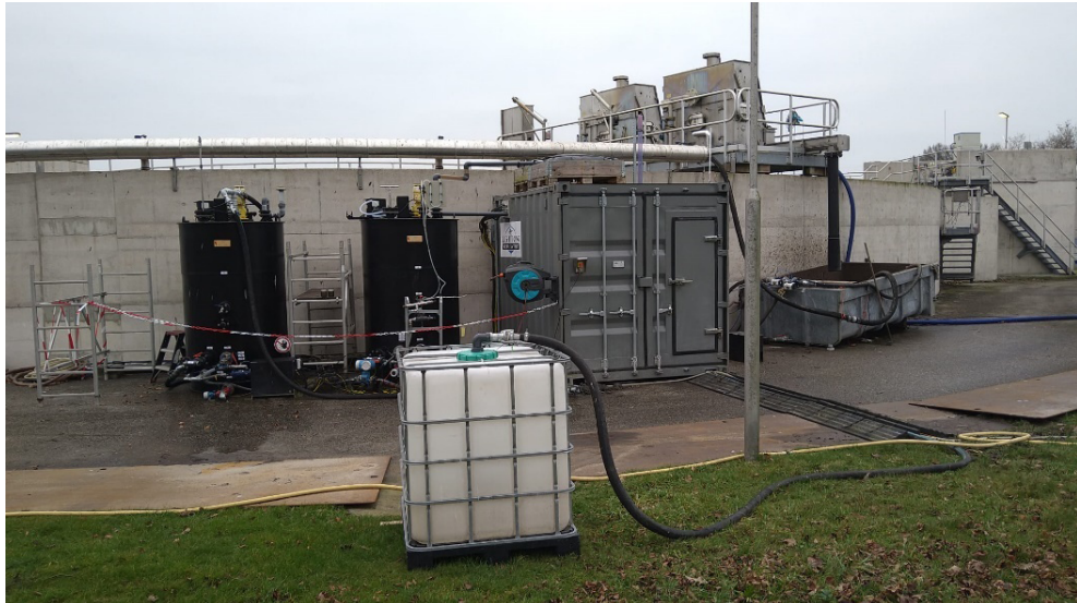
FIGUUR 8 LOCATIE PILOT OP RWZI OMMEN. DE OPEN BAK (RECHTS) IS NA ENKELE WEKEN VERVANGEN DOOR EEN MENG-TANK IDENTIEK AAN DE AL GEPLAATSTE MENG-TANK (HELEMAAL LINKS). DE REACTOR STAAT NET LINKS VAN DE CONTAINER
